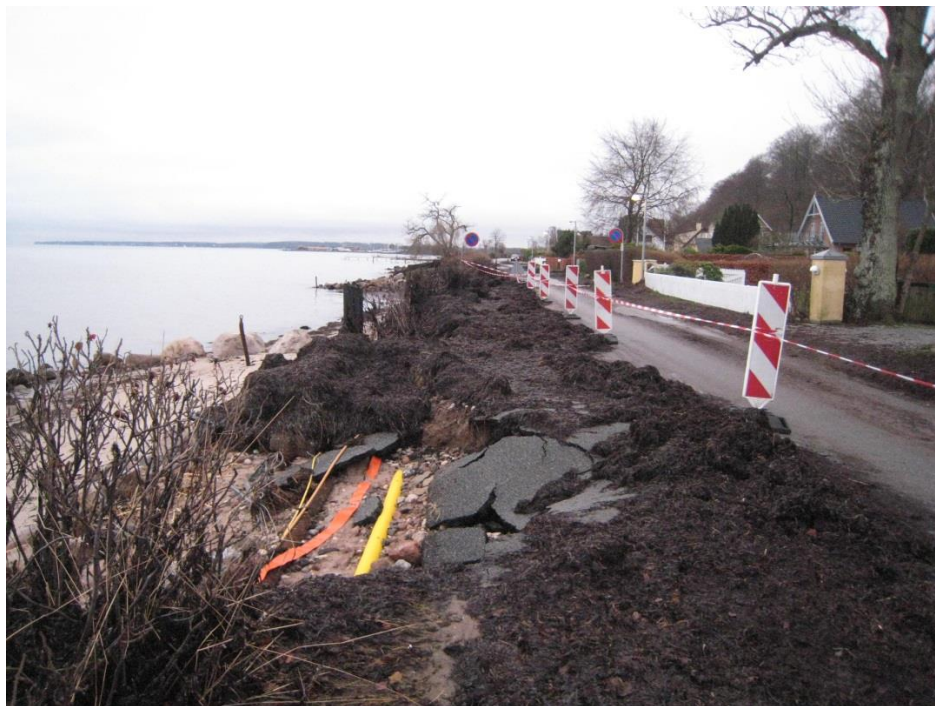
Figur 1.1: Erosion af GI Strandvej under stormen Bodil 5-6. december 2013. Det gule rør viser en gasledning og det orange kabel viser el-ledning, der var eksponeret for bølgepåvirkning under stormen.
